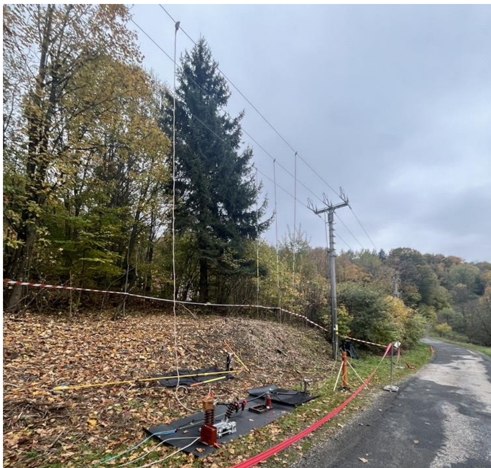
Obr. 2-1 Místo zemního spojení v místě DTS Vlčí 400953
